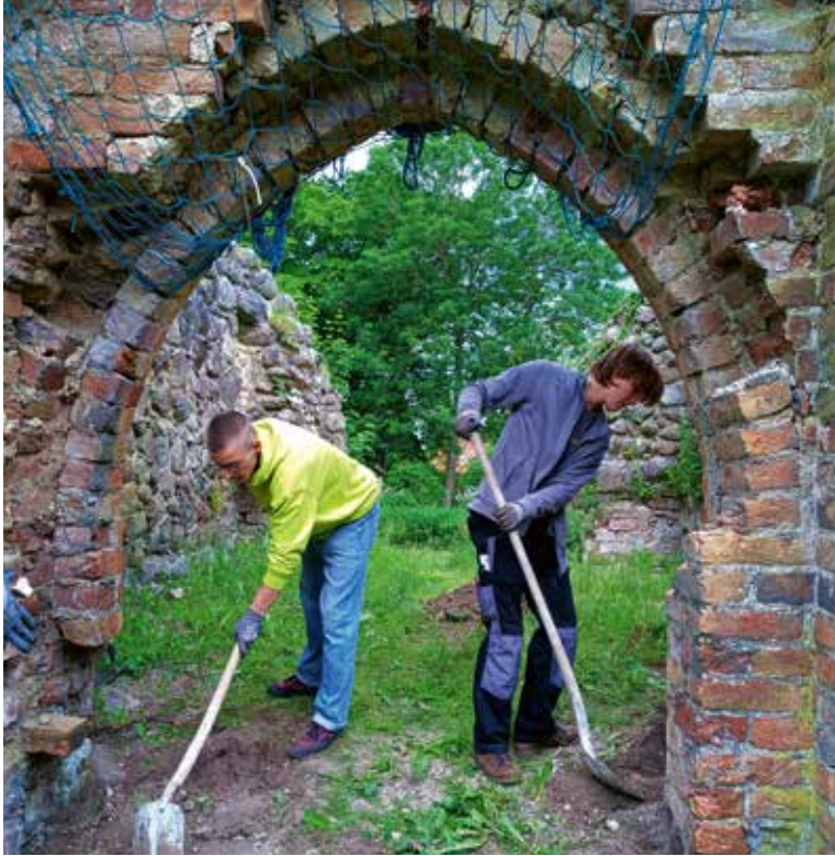
Auch die Steinbearbeitung wird erlernt; Beim Herstellen von Lehmwickeln; Freilegungsarbeiten in der Kirchenruine Steinfurth
